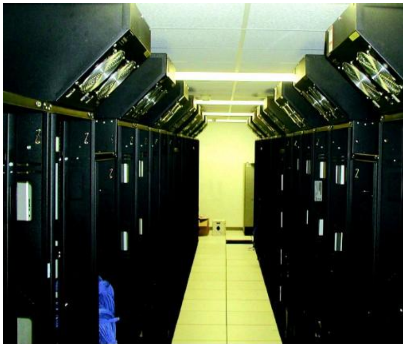
Os sistemas de resfriamento Liebert XDV para racks contendo o Power Mac G5s antes da instalação na Virginia Tech.
